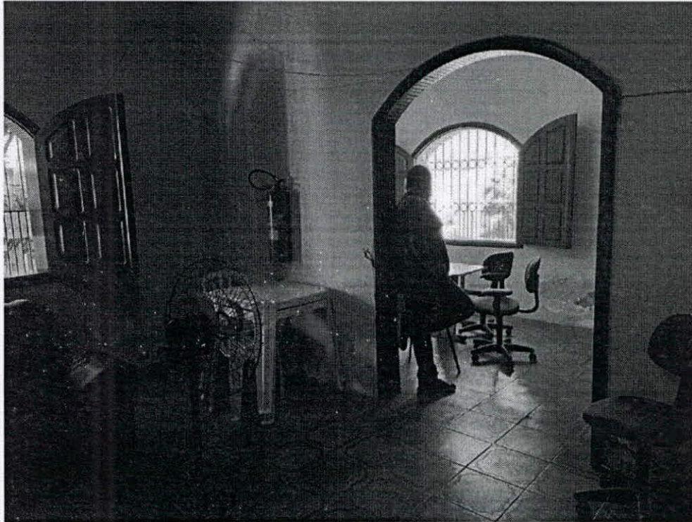
Anexo II- Interior do CAPS II - Má iluminação.
