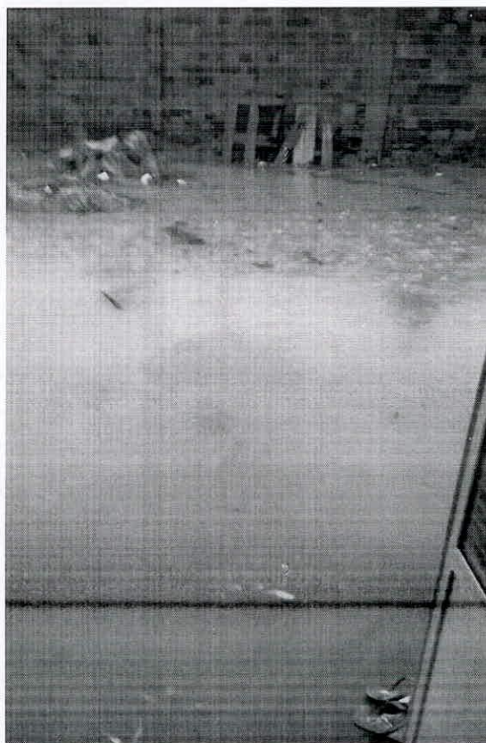
Anexo II – Invasão de água pluvial e retorno de efluentes para o interior para a dos imóveis. Rua Tancredo Neves, bairro Jardim Bahia.
